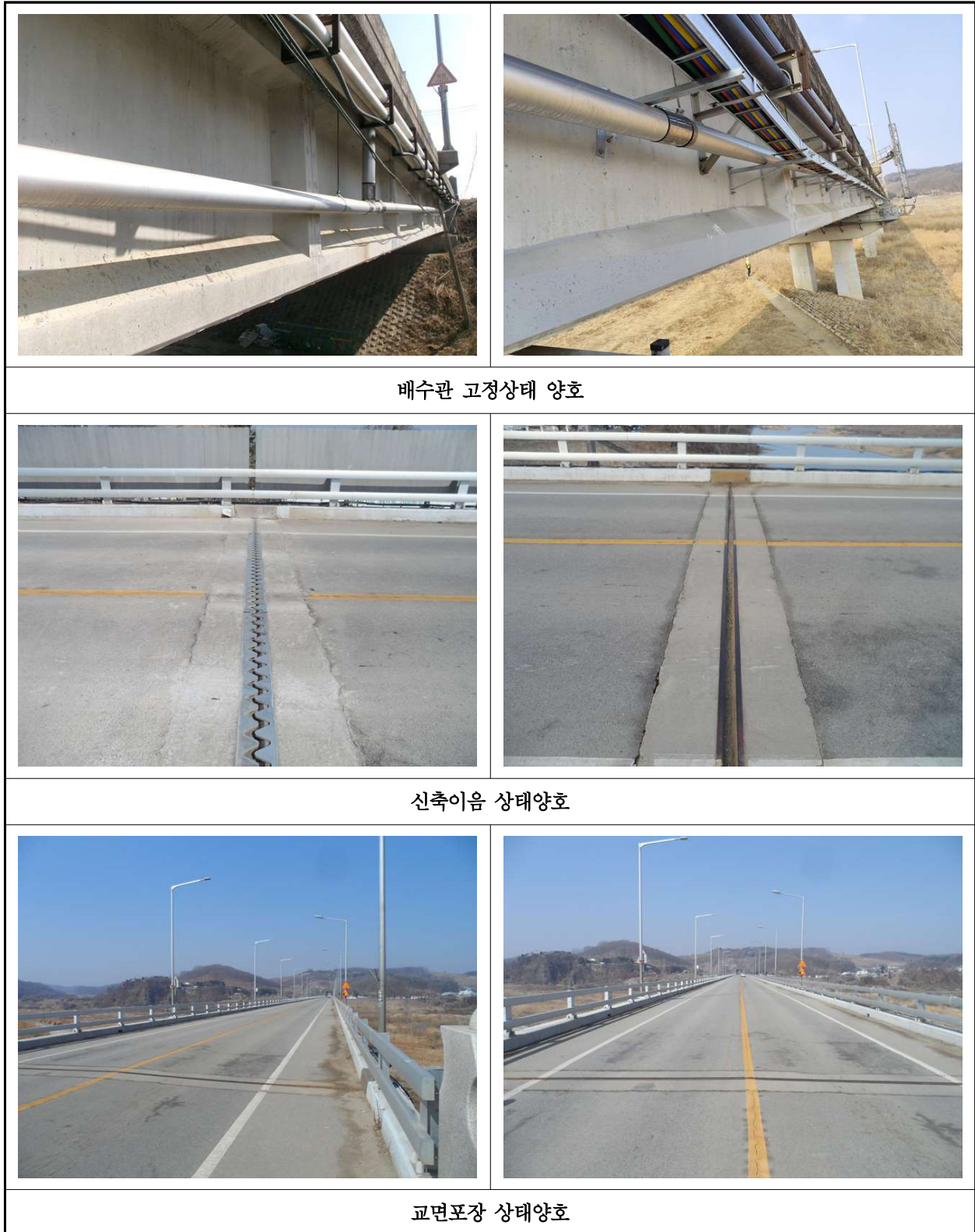
【사진 3.33】 교량의 공중이용시설 10대 위험요소 손상현황(계속)
