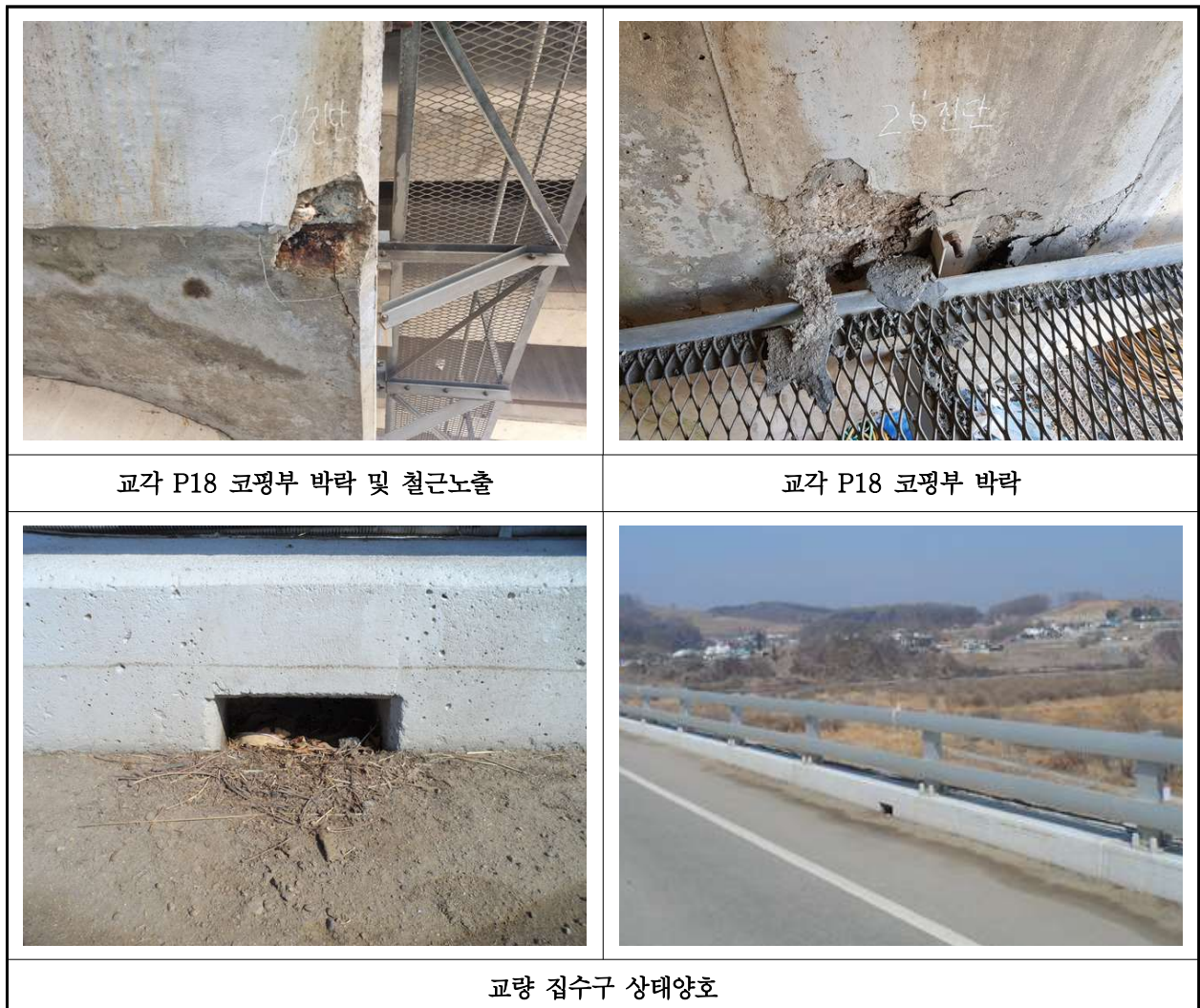
【사진 3.33】 교량의 공중이용시설 10대 위험요소 손상현황
